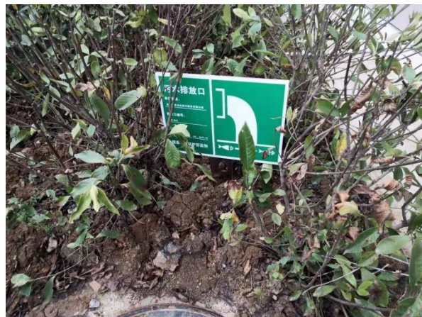
废水排放口标牌
