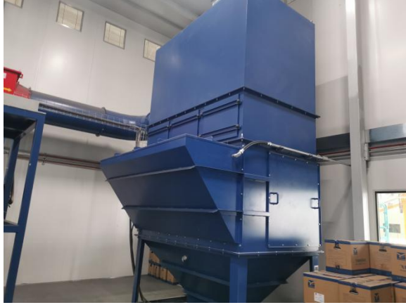
喷塑粉尘治理设施（滤芯回收系统）
