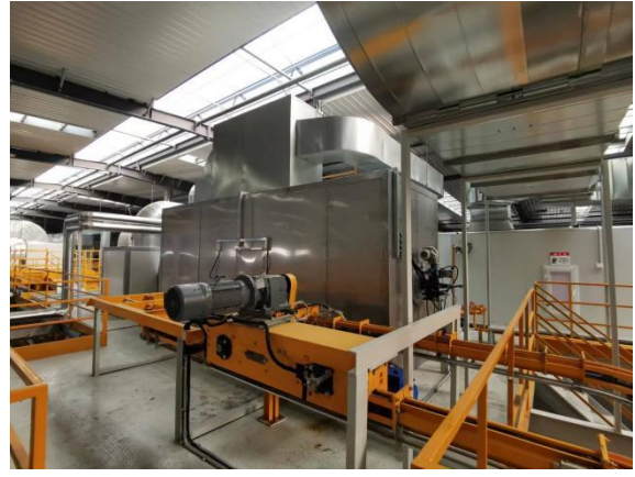
固化废气治理设施（催化燃烧系统）
